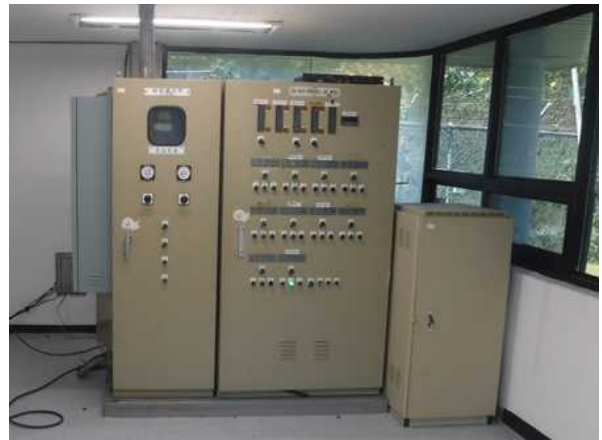
[현장제어반 작동 상태양호]
