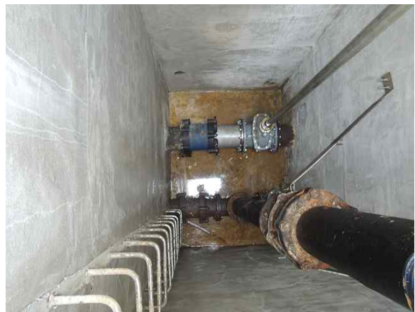
[밸브실 내부 전경]
