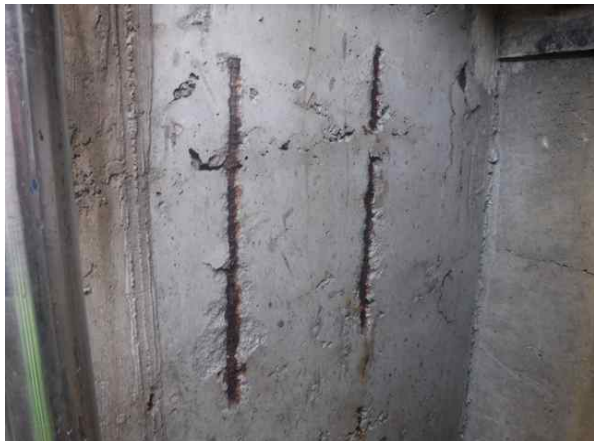
[1호지 유입밸브실 : 철근노출]
