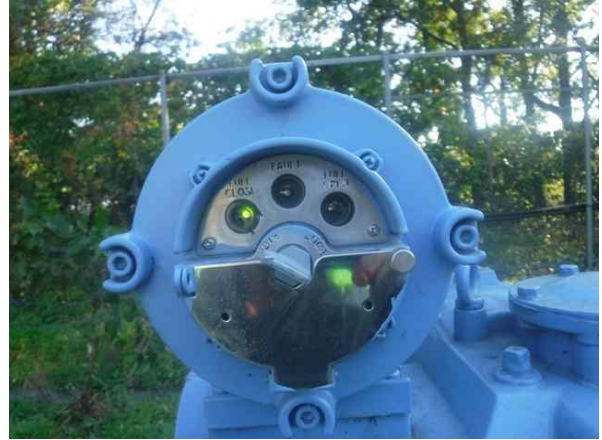
[전동밸브 작동 상태양호]
