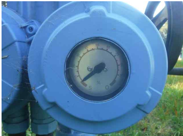
[전동밸브 개도계 상태양호]
